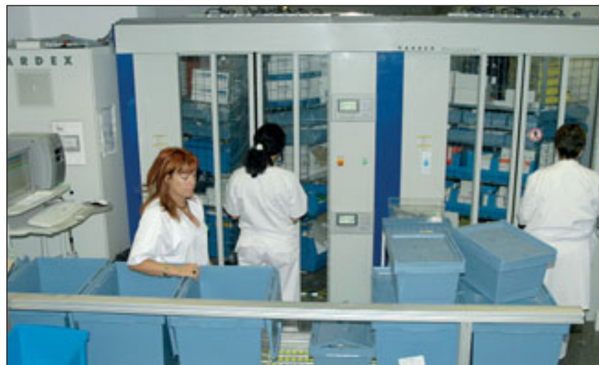
Imagen de los nuevos almacenes dotados de armarios robotizados a temperatura ambiente (izqda.) y refrigerados (dcha.).
